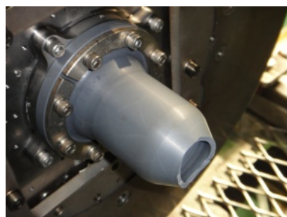
(初期状態) スロート近傍で破損した 燃焼器
