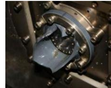
再着火後に破損が進行した燃烧器
