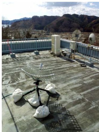
大槌町中央公民館に設置された可搬型アンテナ(径90cmφ)
