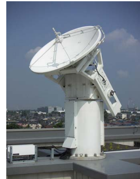
TMS試験局アンテナ
