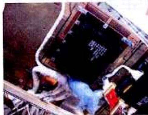
ヒータ制御器 (HCE) (実験機器への加温を行うヒータの制御装置)
